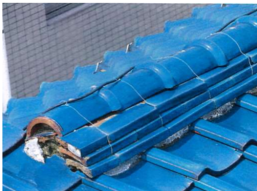
台風により棟瓦が破損した例
