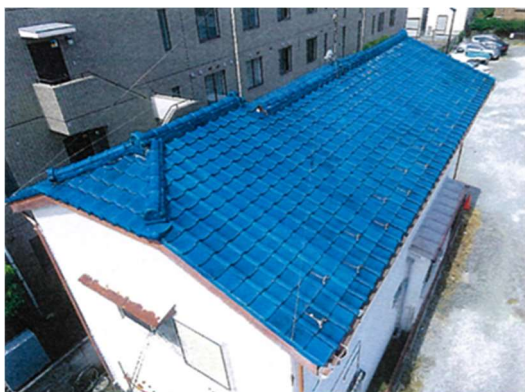
台風により棟瓦が破損した例
