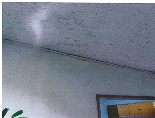
上階からの水漏れにより天井が水損した例
